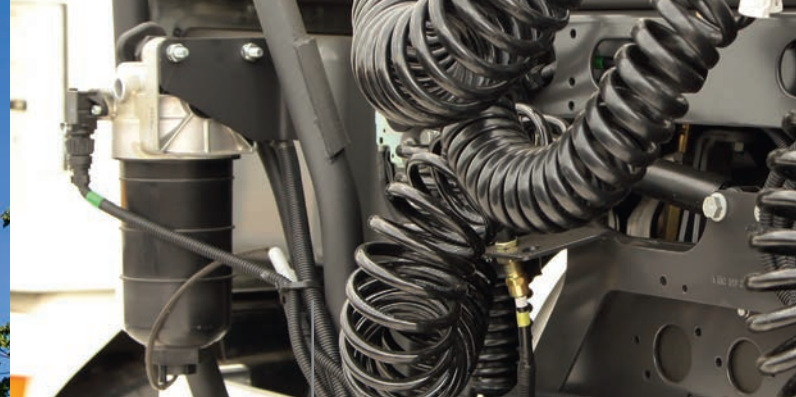
Дополнительная изоляция жгутов электропроводов
